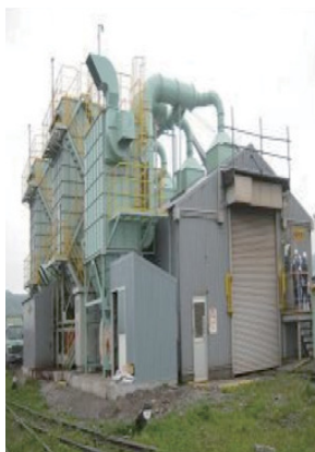
埠頭のガス切断設備(2004年)
