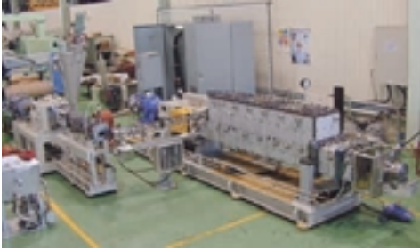
「廃プラ脱塩素装置」
