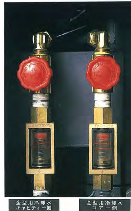
写真6 金型冷却水用フローメーター
