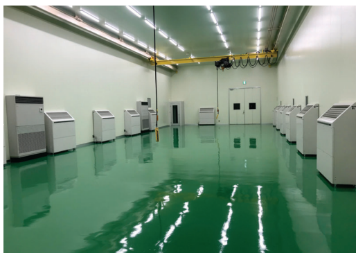
写真3 クリーンルーム
