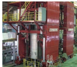
150トンエレクトロスラグ溶解炉 150-ton Electroslag Remelting Furnace
